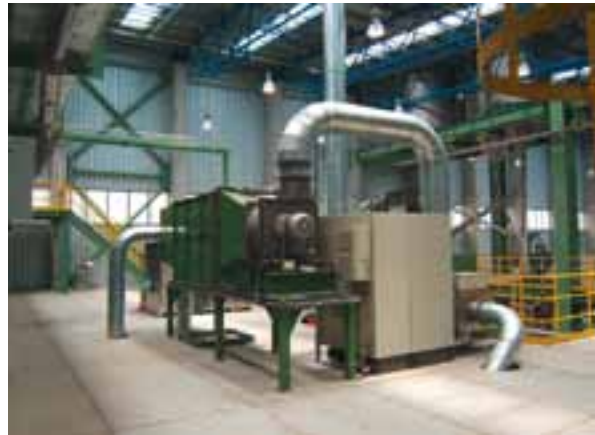
Vollständiges Filtersystem nach der Inbetriebnahme
